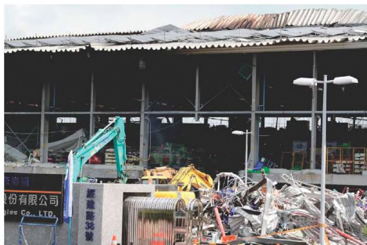
屏東明揚公司廠房爆炸意外釀重大死傷，圖為去年9月27日獲救人員將一根天花板打碎，讓墜入內拉出大型操作機器。(中央社檔案照片)
