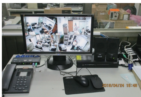
機房錄音錄影監控系統
