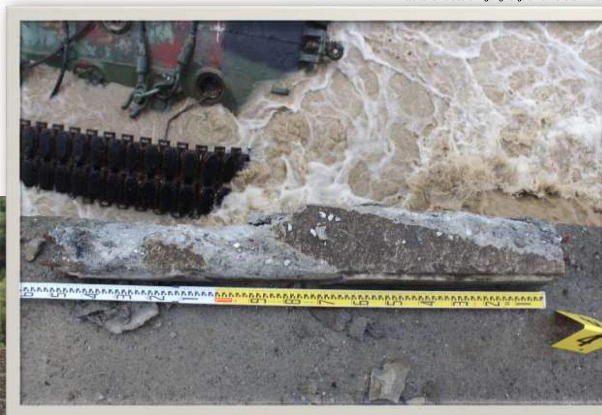
編號第 4 號護欄毀損情形
