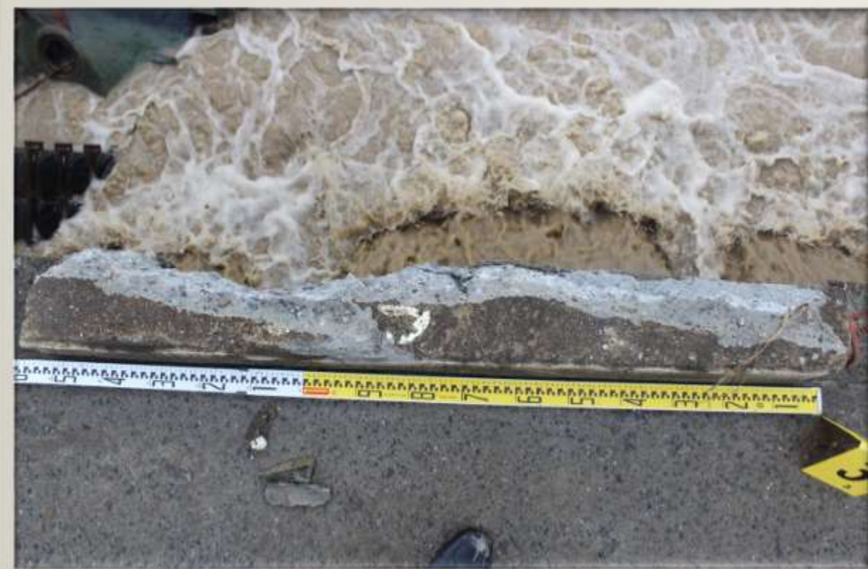
編號第 3 號護欄毀損情形
