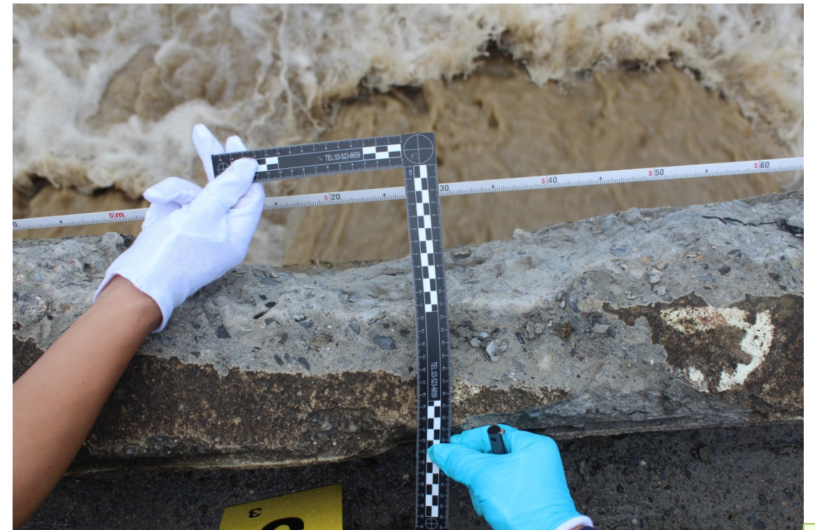
量測編號第3號護欄受損情形
