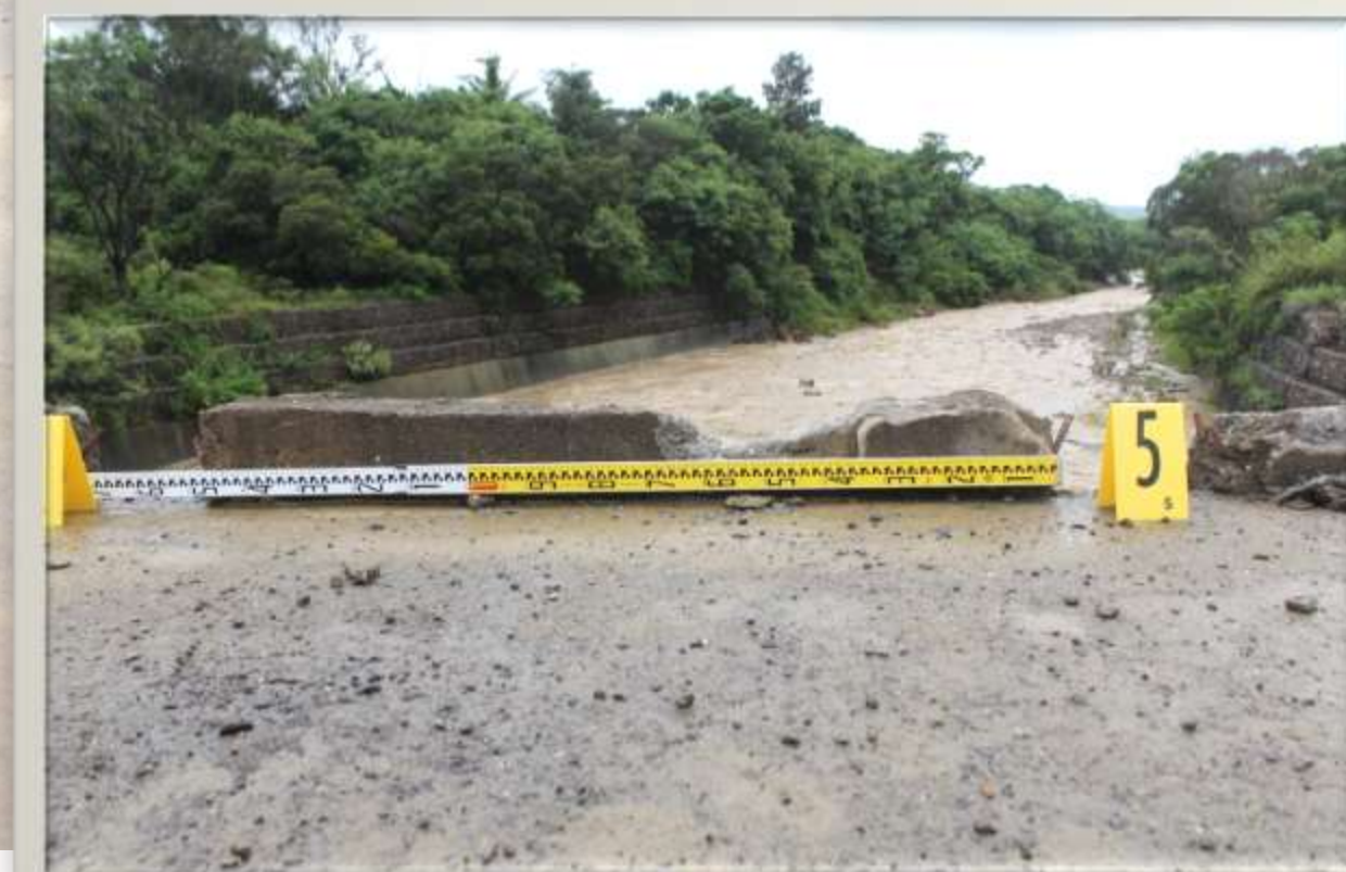
編號第 5 號護欄毀損情形
