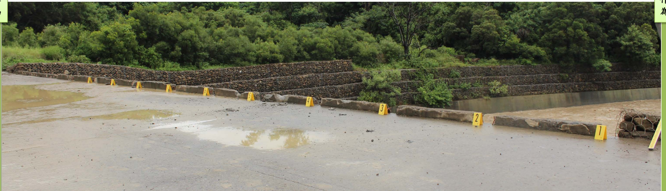
針對每座護欄受損情形進行勘察
